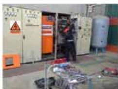
تابلو کنترل دیزل ژنراتور
